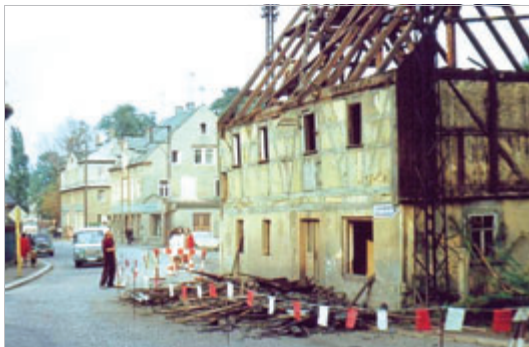
li.: Das baufällige Gebäude um 1970: am Fachwerk sind bereits starke Schäden auszumachen. re.: Abriss 1972
